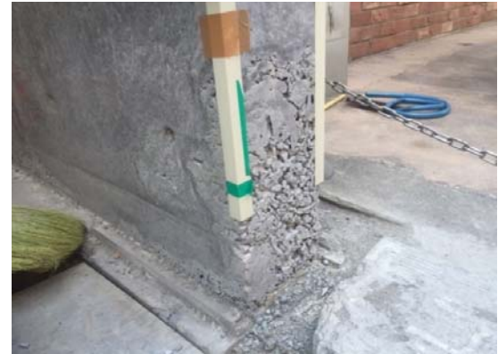
ジャンカ ※生コンが浸透しきれていない。
