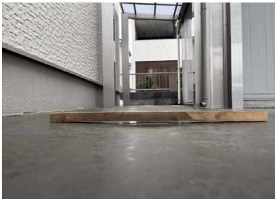
歪み ※硬化スピードの違い、沈下など
