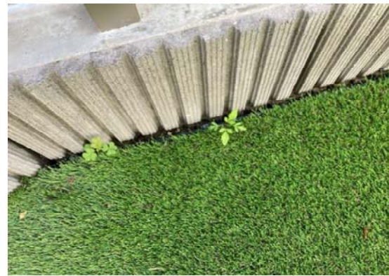
人工芝・防草シート端部は雑草等の生成あり
